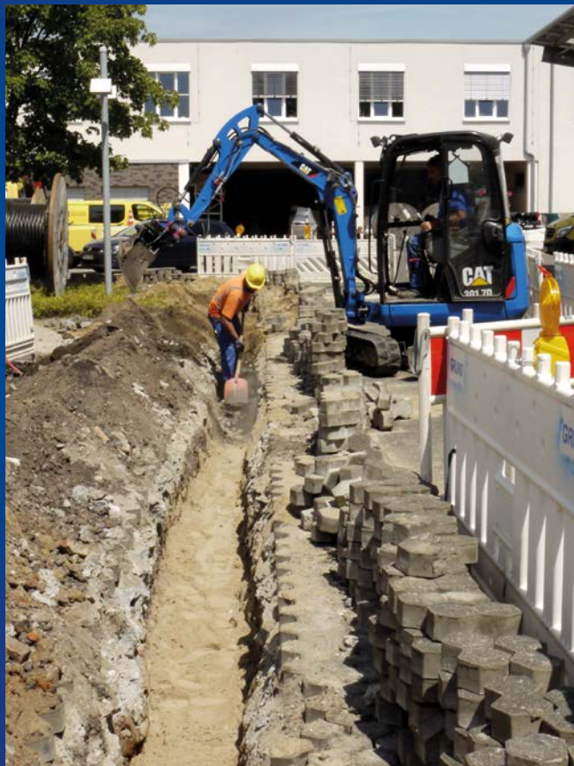
Das Troisdorfer Highspeed-Netz bekommt zwei Übergabe-Punkte ans nationale Glasfasernetz. Einer davon wurde im Sommer auf dem Gelände der Stadtwerke eingerichtet.
